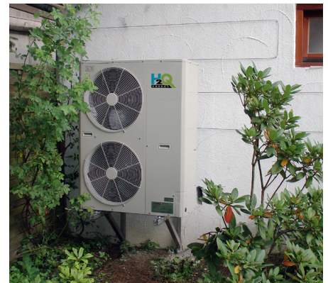
Aufstellung der Split-Wärmepumpe im Freien
