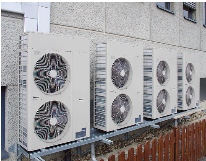
Referenzanlage Dekra Möhringen, 90 kW Anlage Aufstellung der Split-Wärmepumpen (H2Q-9000) in Kaskade
