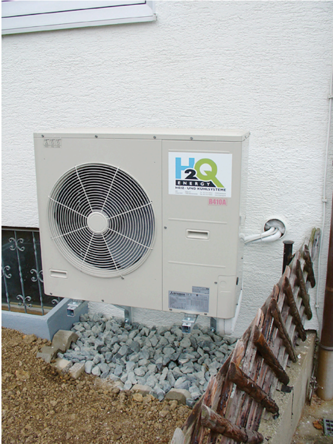
Referenzanlage Heizungsmodernisierung im Einfamilienhaus, 10 kW Anlage Aufstellung der Split-Wärmepumpe (H2Q-1000) im Freien
