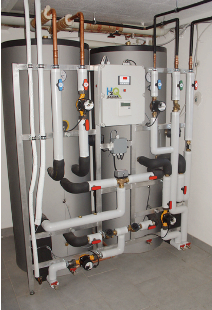
Aufstellung des H2Q-Energiespeichersystems im Gebäude (H2Q-ES-400)
