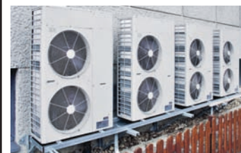
Referenzanlage Dekra, 90-kW-Anlage Aufstellung der Split-Wärmepumpen (H2Q-9000) in Kaskade
