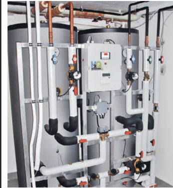
Aufstellung des H2Q-Energiespeichersystems im Gebäude (H2Q-ES-400)
